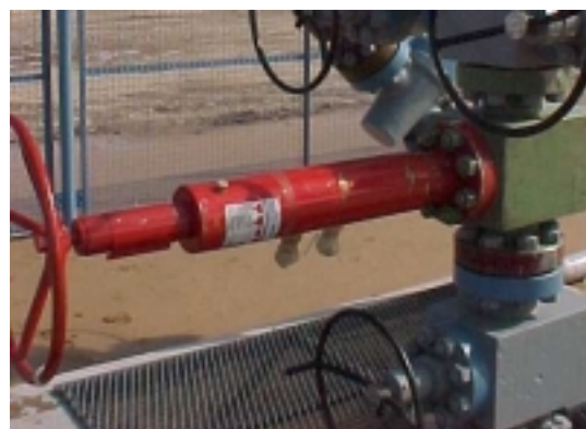
Figura 2: Actuador hidráulico montado sobre la válvula maestra de armadura de urgencia
