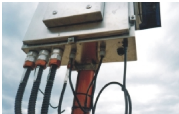
Figura 9: en esta vista se aprecia la parte inferior del cableado antiexplosivo flexible en su acometida al WCU
