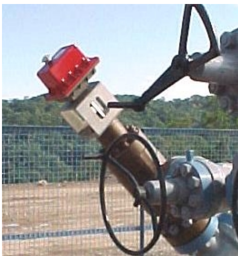
Figura 6: Entre el actuador eléctrico y el Choke va montado un kit de enlace mecánico
