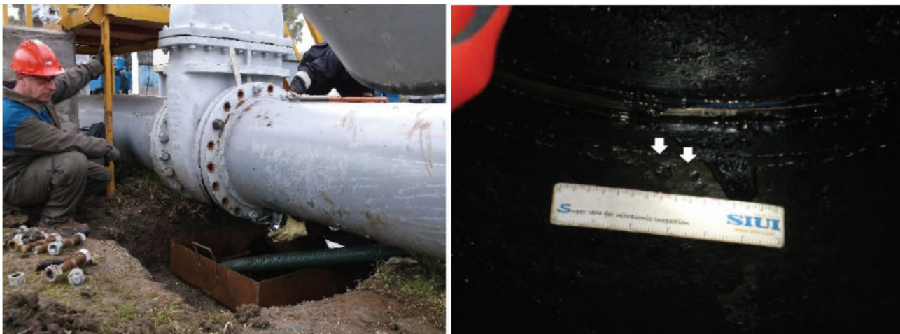
Figura 9. Residuo de hidrocarburo negro y viscoso filtrando del extremo de la válvula del niple de 24" (izquierda) y la corrosión interna localizada (flechas) en la parte inferior de la válvula (derecha).
