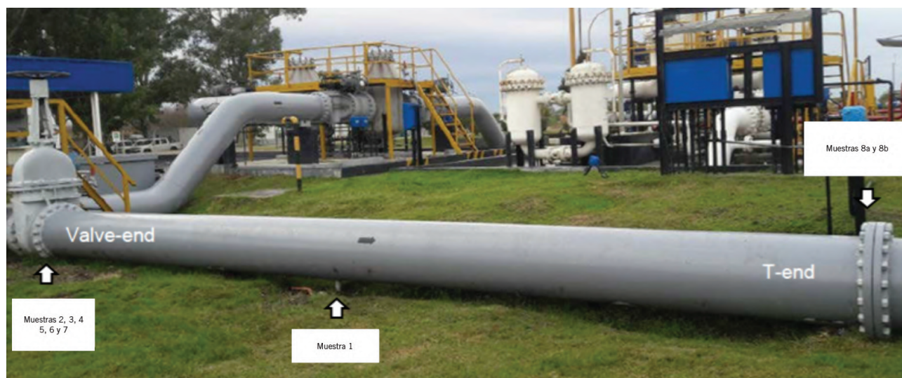
Figura 3. Niple de 24" de diámetro ubicado en Cabecera La Plata.
