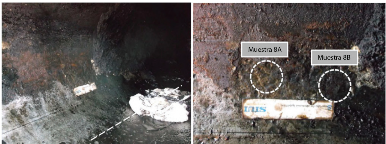
Figura 8. Corrosión interna del extremo de la válvula en el niple luego de una limpieza parcial. Notar la presencia de depósitos de hidrocarburos en la esquina superior derecha (izquierda), y el óxido superficial y morfología de corrosión localizada (derecha). La línea blanca indica la posición horaria 6:00.
