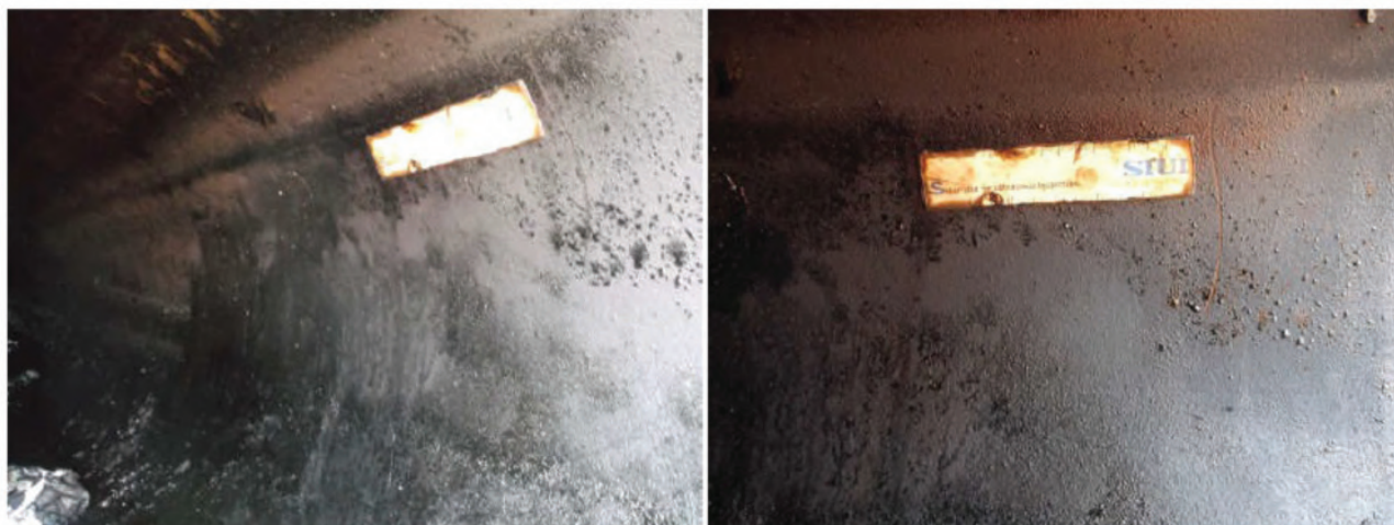
Figura 10. Corrosión superficial uniforme en la mitad superior de la línea.
