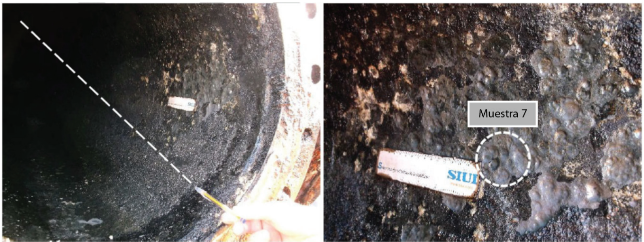
Figura 7. Escala y morfología de la corrosión localizada que afecta la mitad inferior de la línea en el accesorio T. La línea blanca indica la posición horaria 6:00.
