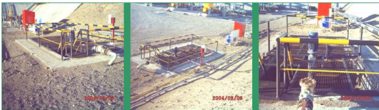
Figura N°16: Vistas de la cámara principal de 19 m 3 del sistema de drenajes
