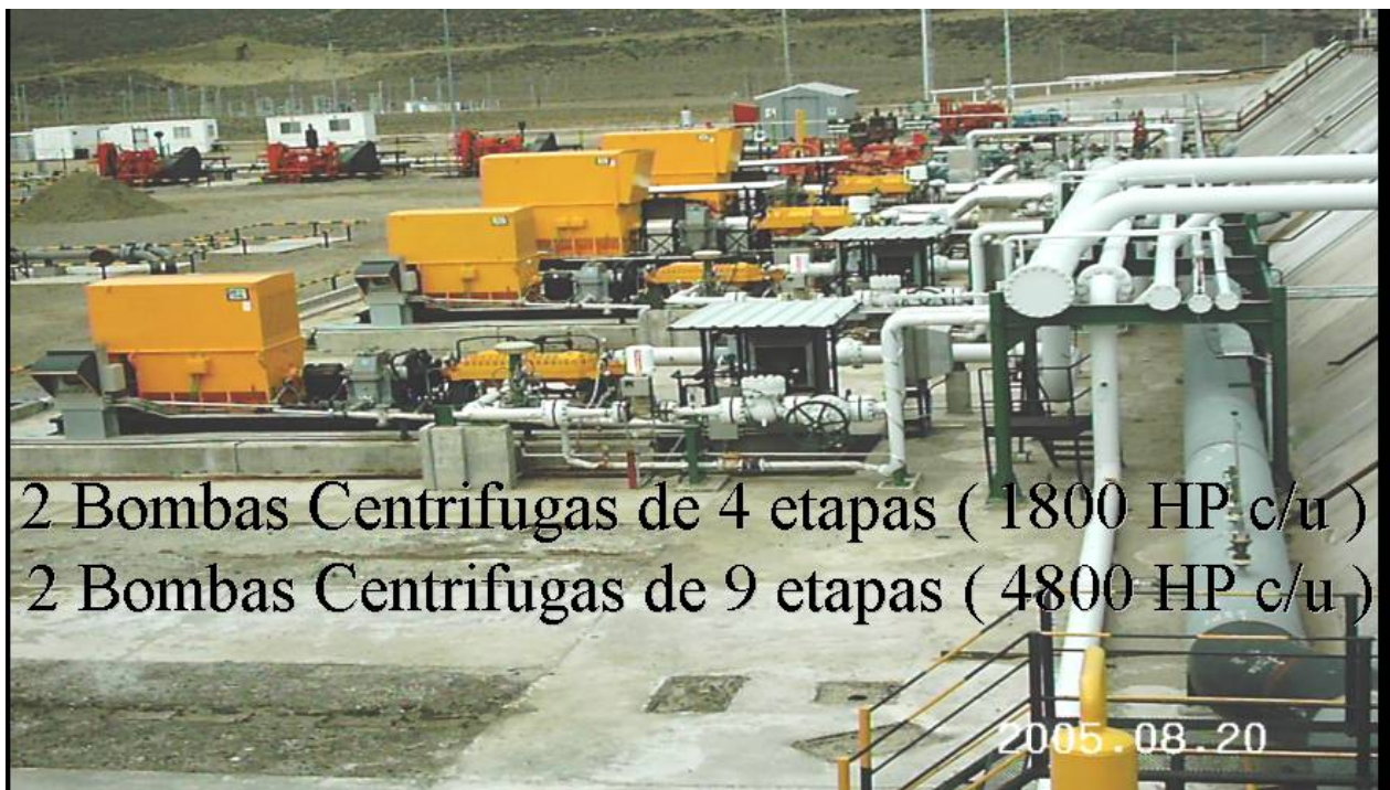
Figura N°8: Parque de bombas actual de la planta Zorro 2
