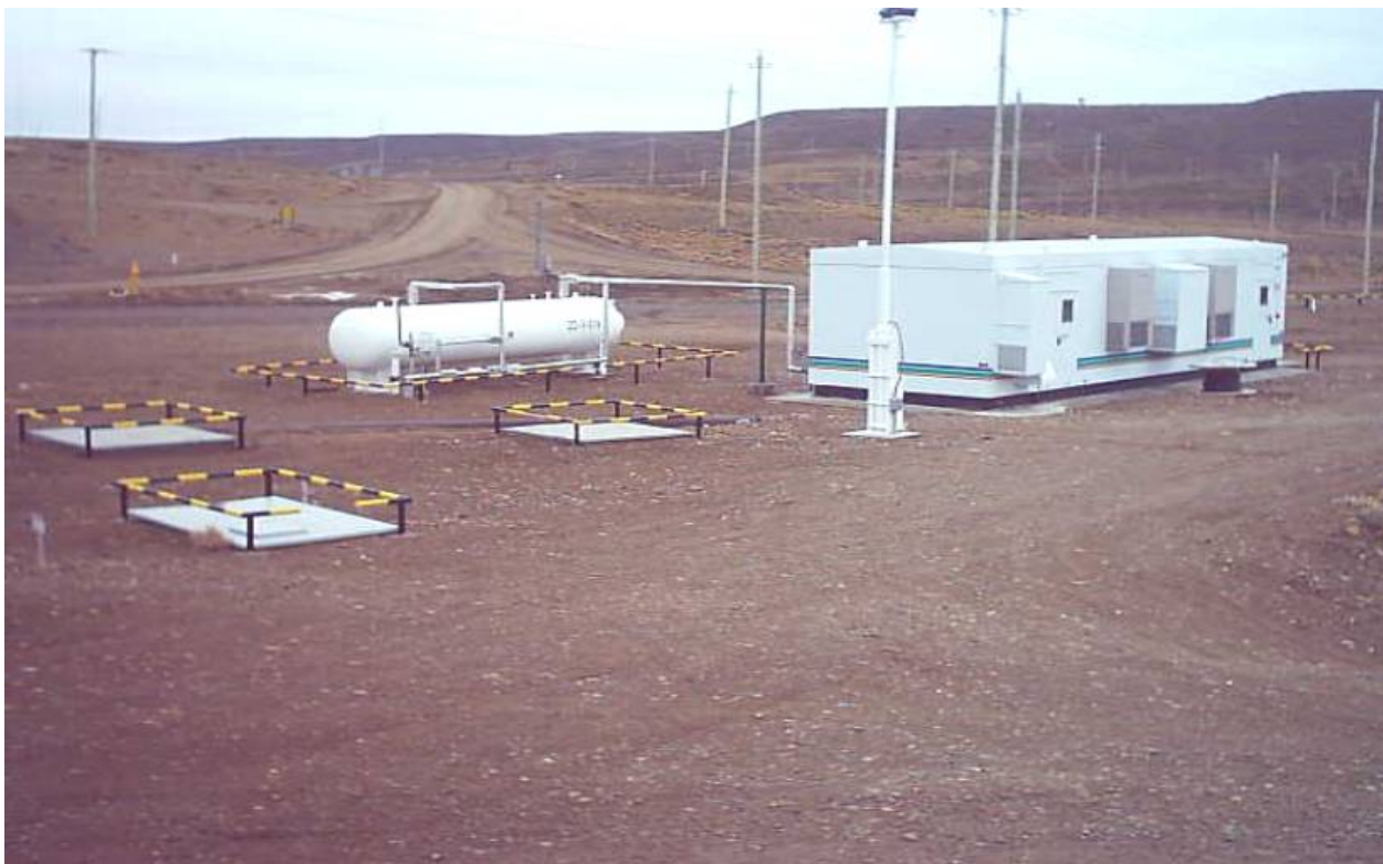
Figura N°13: Planta de aire seco para sistema de control
