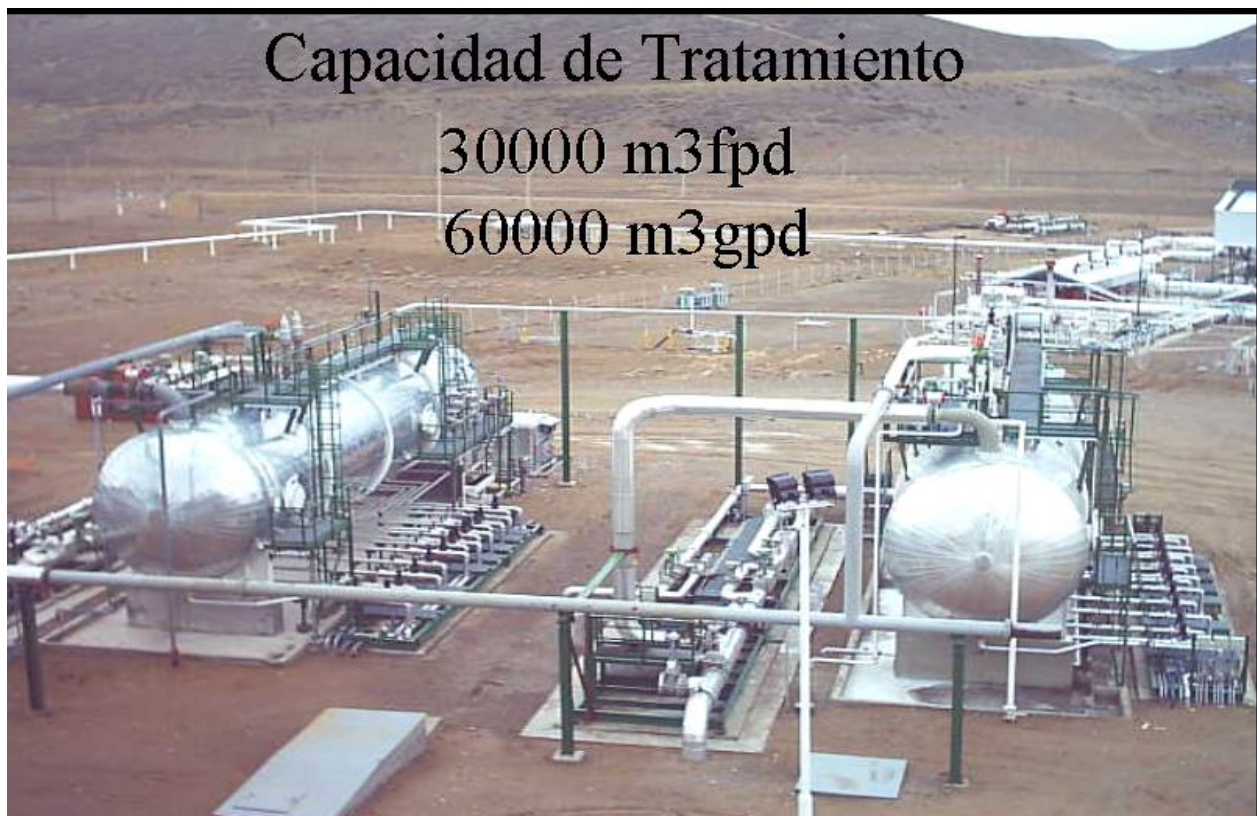
Figura N°9: Vista de los equipos FWKO
