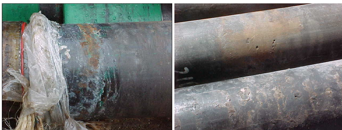
Fotos 3 y 4: picaduras por Crevise en Tubería 13Cr causada por los aros de protección
