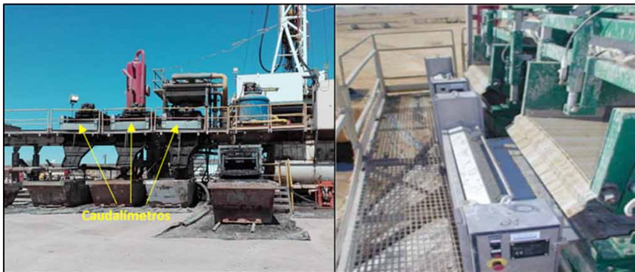
Figura 5. Ejemplo de instalación de caudalímetros en zarandas.
