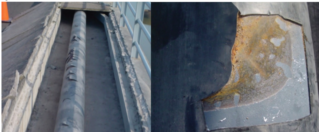
Figura 11. Revestimiento con capa de polietileno degradada, encontrada en cañería bajo trinchera.
