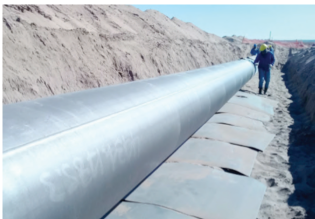
Figura 7. Falla nivel 2. El 3LPE sin adherencia yace en el suelo.
