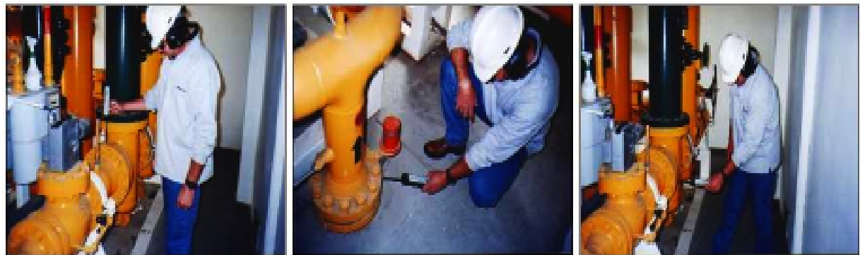
Mediciones de pérdidas en Estación de Medición y/o Regulación Río IV (Recinto cerrado)
