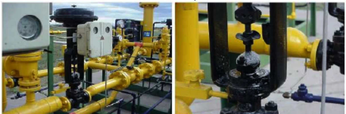
Mediciones en Estación de Medición y Regulación de Pta. La Paz
