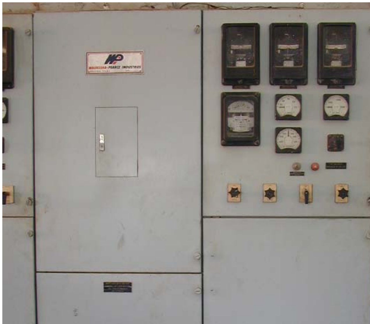
Fig 1.1 Paneles de Generadores Antiguo
