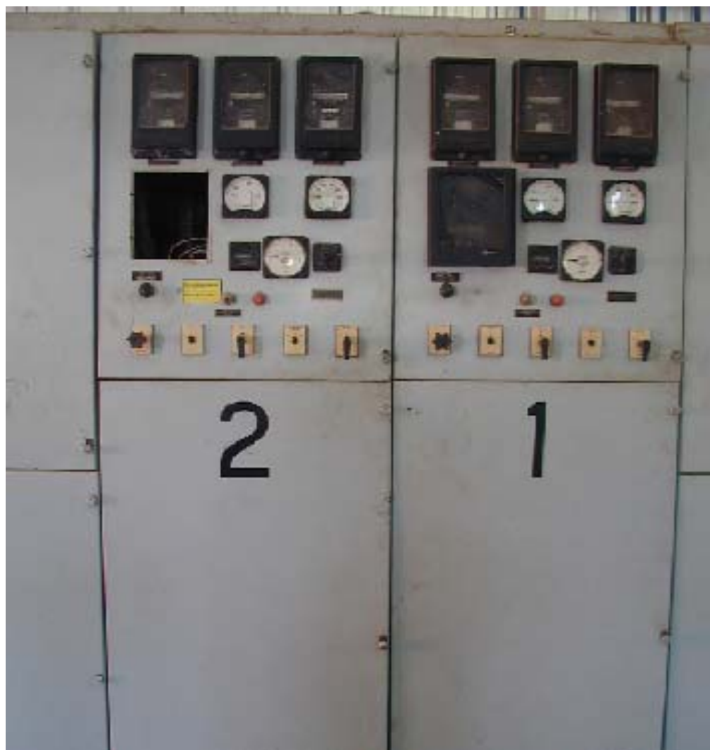
Fig 1.2 Paneles de Generadores Antiguo
