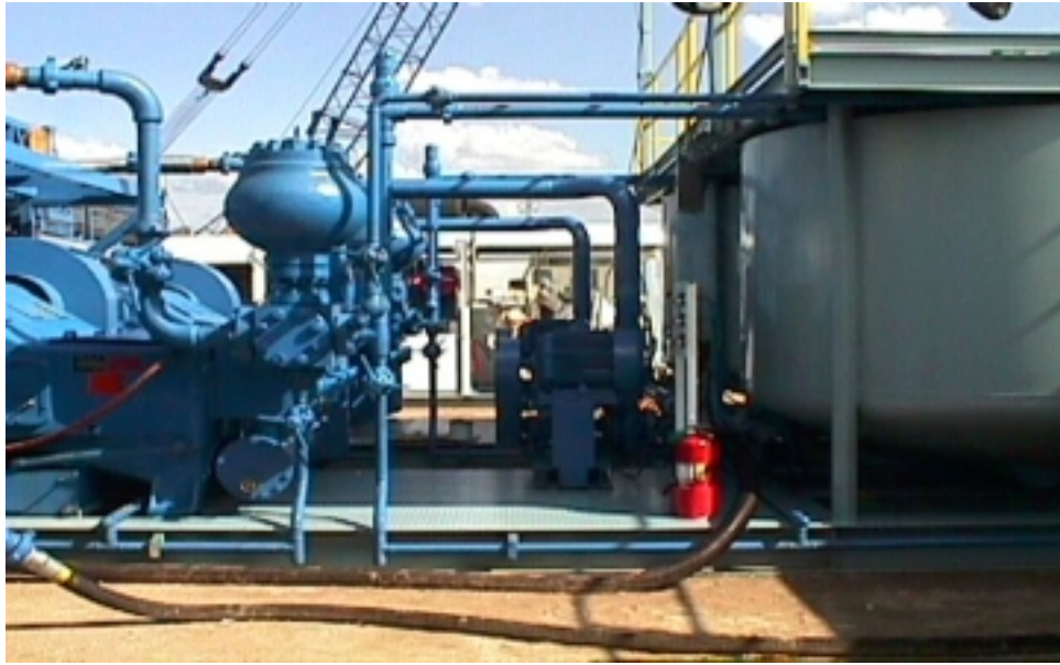
FIG. 6: PATIN PARA EQUIPOS DE CONTROL DE SOLIDOS
