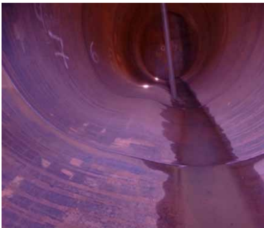
Figura 6. Abolladura observada en el interior del tanque.
