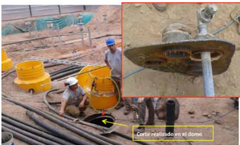
Figura 2. Intento de reparación del tanque ya enterrado.
