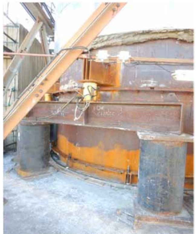
Figura 14. Fotografía de sistema de elevación.
