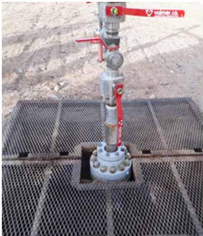
Figura 19. Imagen y esquema de árbol de inyección instalado.
