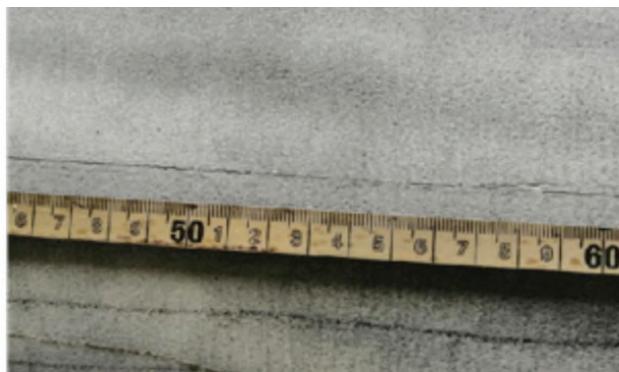
Foto 23. Notch informado por UTCD.
