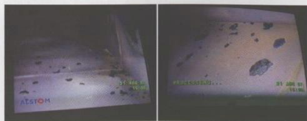
Figura 8. Fotos de inspecciones boroscópicas de la cámara de combustión EV.
