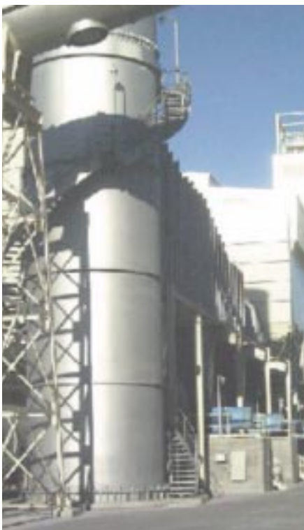
Figura 6 • Planta de Tratamiento de humos
