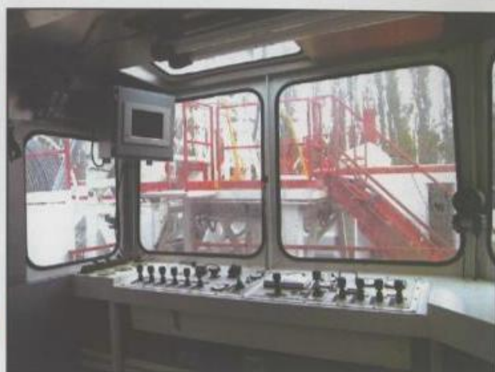
CTD-01 Cabina de operaciones
