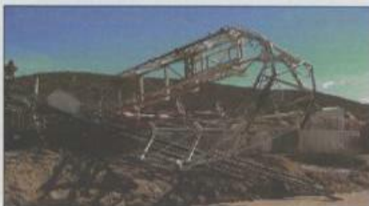
Figura 1. Equipo IDECO luego de la ruptura del tramo superior.
