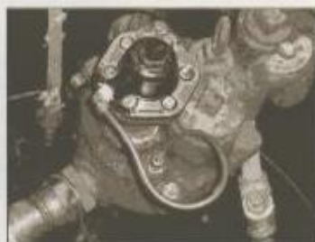
Figura 6. Bomba sumergible. En primer plano se ve el detector mecánico de pérdidas.
