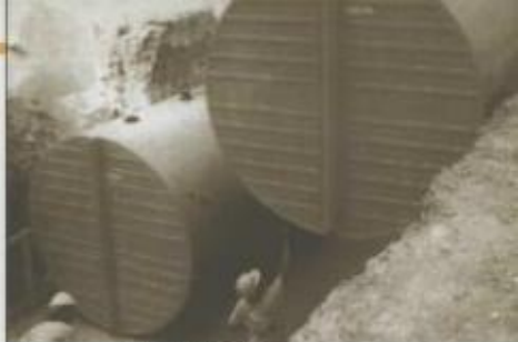
Tanques metálicos de doble pared.
