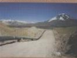
Gasoducto Gas Andes
