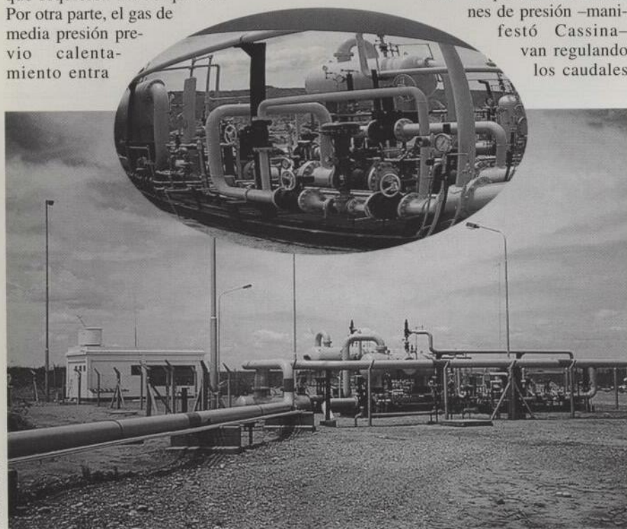
Batería central de gas (Sala Control Central)
