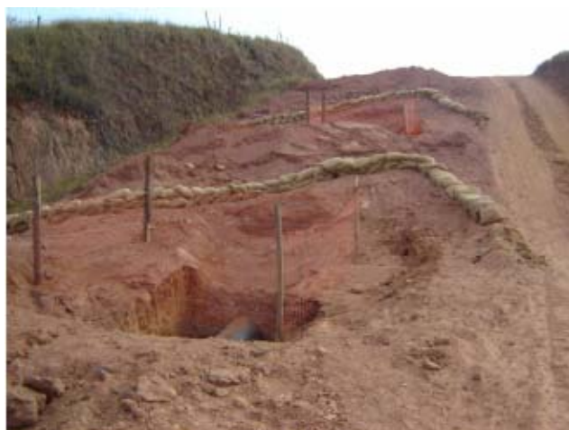
Figura 2. Dispositivos instalados para controle de carreamento de material sólido.
