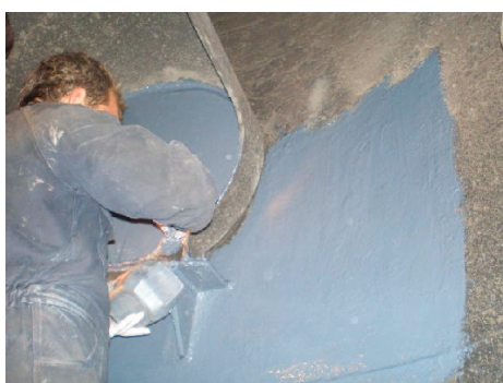
Figura 21 – Revestimiento zona Ingreso de reboiler a Still
