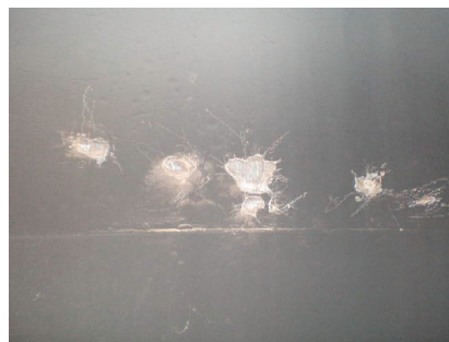
Figura 18 – Ampollamientos de revestimiento entre platos 8 y 9
