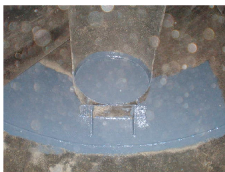
Figura 22 – Revestimiento zona Ingreso de reboiler a Still
