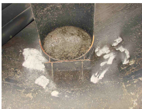
Figura 19 - Ingreso Vapores de Amina a Still
