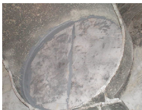
Figura 20 - Ingreso Vapores de Amina a Still
