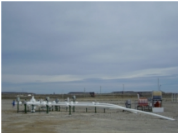
Fig. 7: Pozo de alta presión PTP-829
