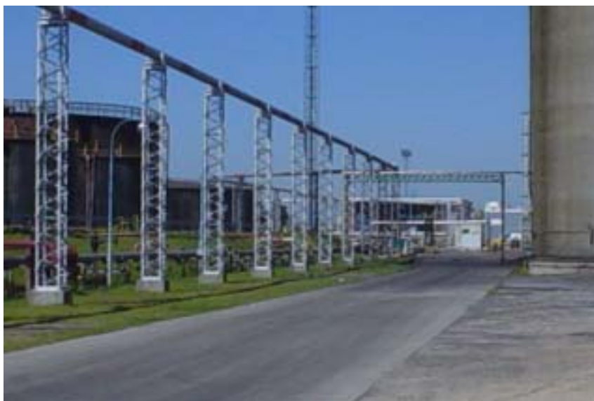
Vista líneas aéreas
