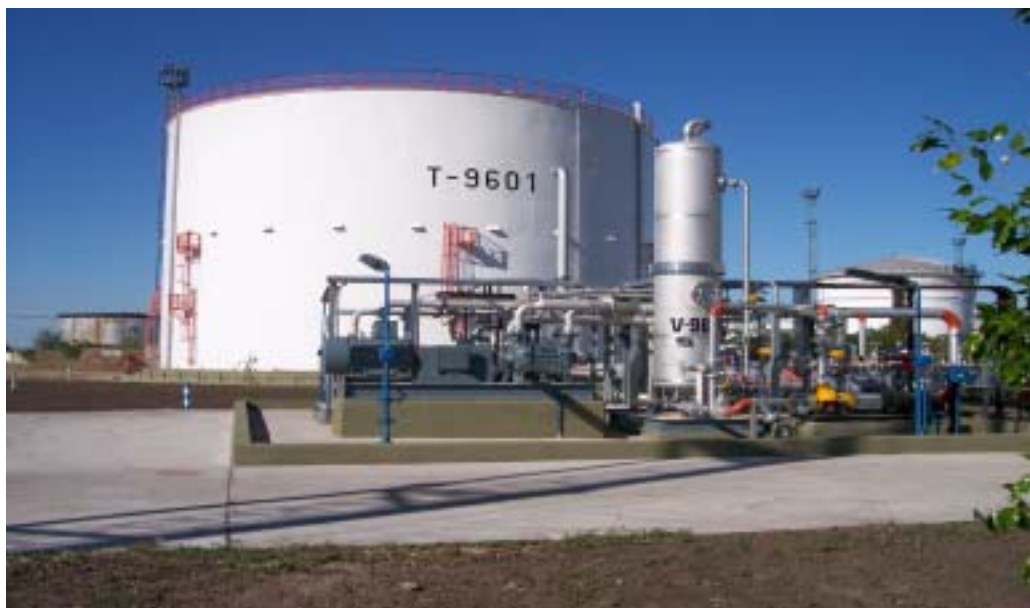
Unidad Recuperadora de Vapores y Gasómetro
