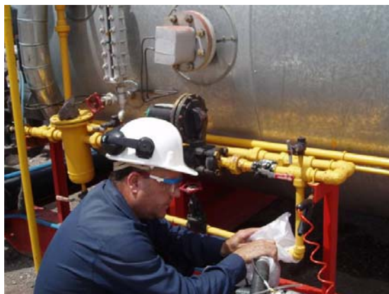
Foto 2. Personal técnico realizando mediciones con el equipo Hi Flow Sampler en una unión doble de un calentador. En este caso, se usó la bolsa de nylon y la boquilla como accesorio adecuado para capturar la fuga.
