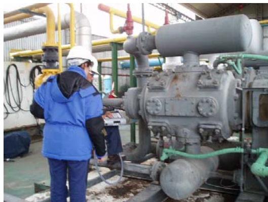
Foto 1. Personal técnico realizando mediciones con el equipo TVA 1000B en motocompresores de la planta de compresión perteneciente a la planta de tratamiento de gas del yacimiento Los Cavaos.
