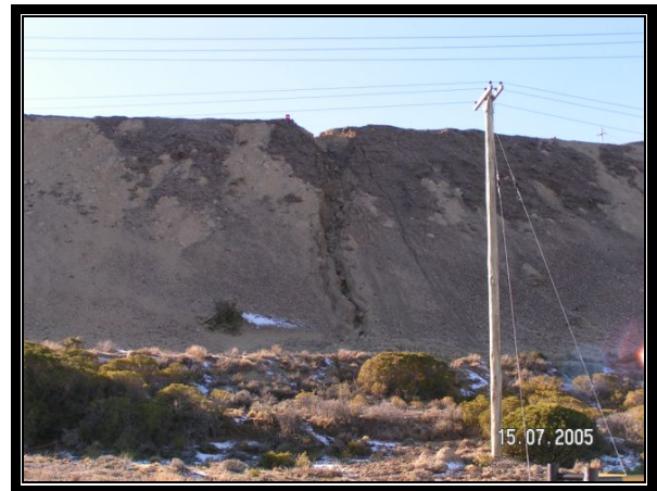
Cárcava en talud de locación
