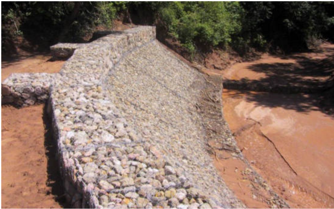
Foto 11: Deflector. Estructuras como la mostrada, formada por un terraplén de suelo seleccionado y compactado revestido con membranas y gaviones, cumple la función de provocar desvíos de caudales. Cabe aclarar que el desvío de un cauce solo se ejecuta cuando no existe otra opción factible frente al problema planteado.
