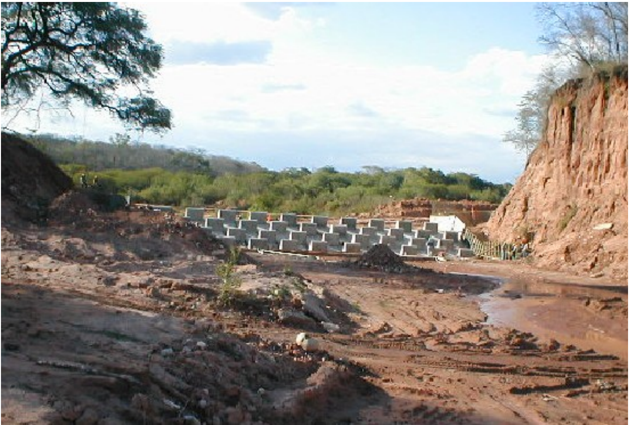
Foto 7: Salto hidráulico. Vista desde aguas abajo de un salto hidráulico con rápida dentada y cuenco disipador (no visible). Una obra de este tipo permite salvar desniveles en el recorrido del agua evitando que esta provoque erosión retrógrada. En este caso, también se trata de un badén que permite por un lado atravesar la quebrada y por otro estabiliza la cota de fondo, evitando que queden al descubierto 5 ductos que cruzan la quebrada enterrados aguas arriba de la obra.
