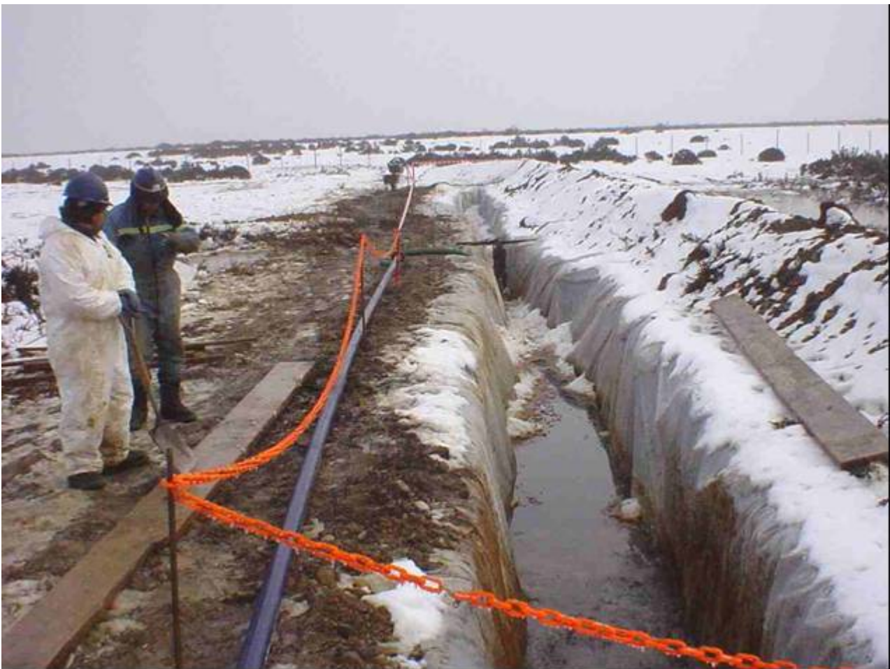
Fotografía 1: Dique de contención final del derrame
