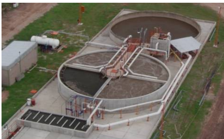
Fig.6 – Planta de Tratamiento Biológico de Efluentes – REFINOR S.A.
