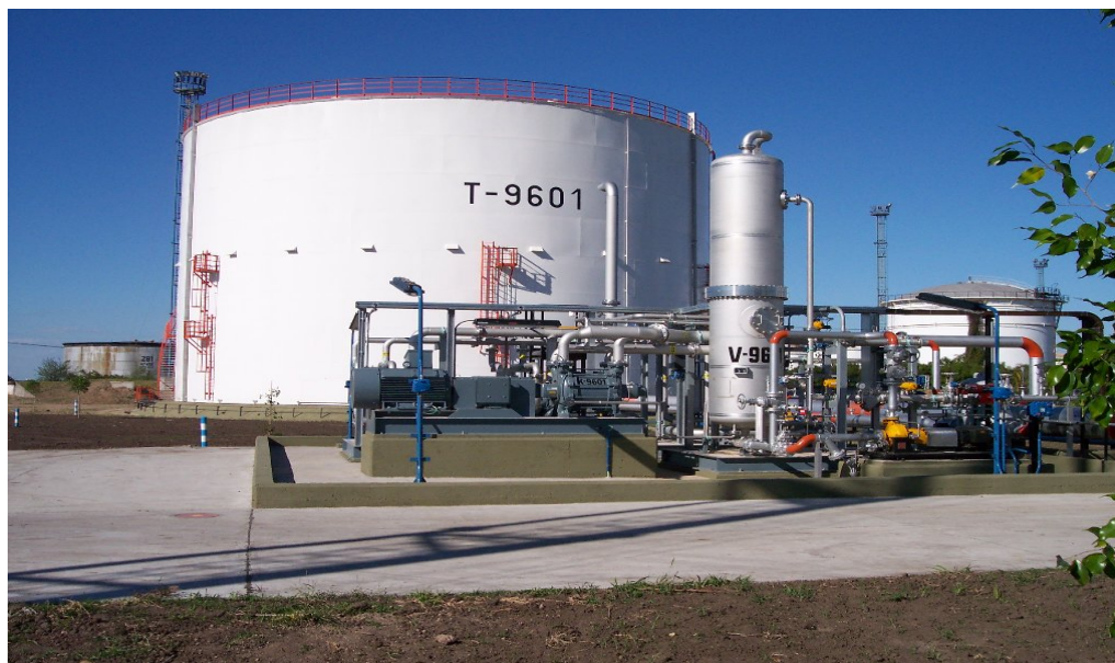
Unidad Recuperadora de Vapores y Gasómetro
