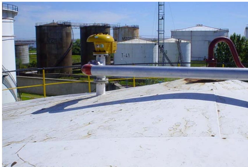
Línea conexión de tanque a sistema de recuperación antes de la válvula de presión y vacío
