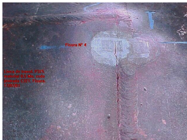
Fig. 3b – Fisura en ultimo codo línea de tope reactor
