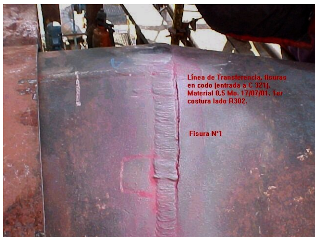
Fig. 3a – Fisura en último codo línea de tope reactor
