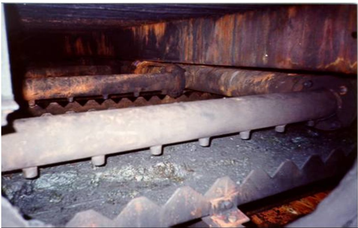
Foto 2: Distribuidor superior con picos rociadores tapados y bandejas con mucho carbón.
