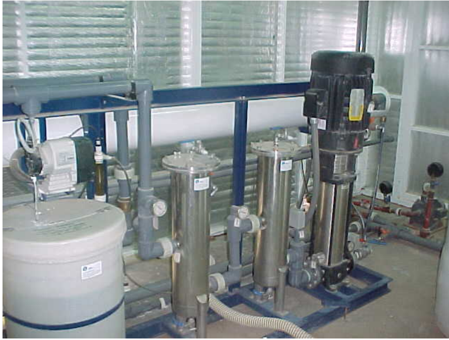
Planta de tratamiento de agua.
