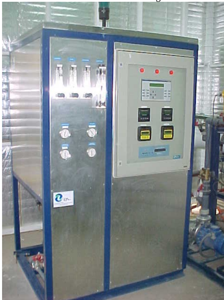
Planta de tratamiento de agua.
