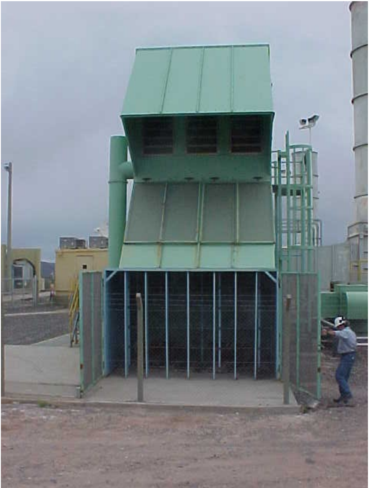
Vista de la malla de pulverización de agua
