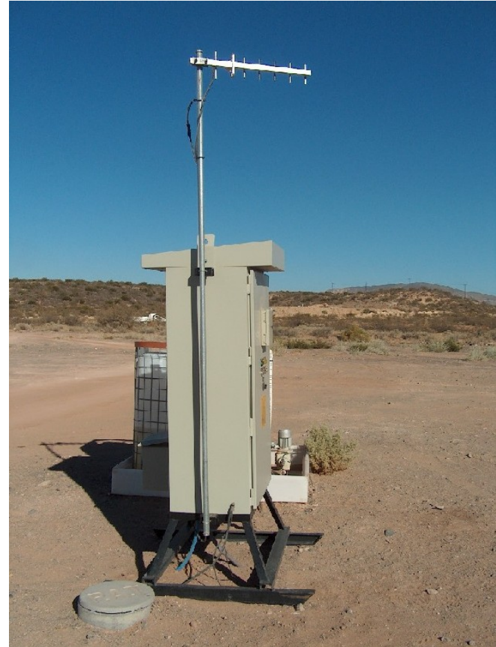
Idem: Observar antena de radio para telecontrol.
