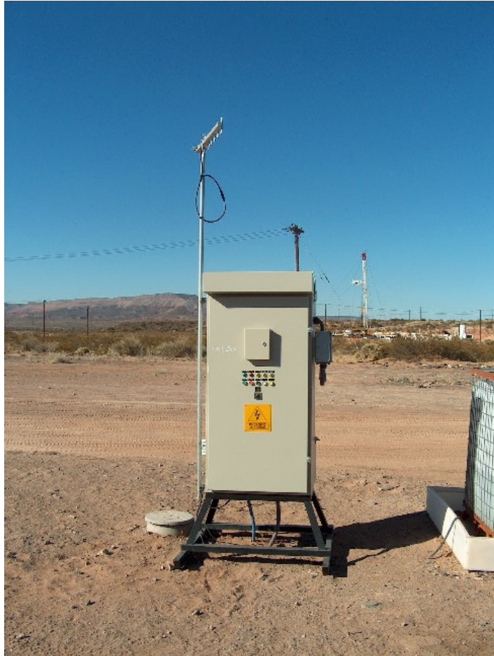
Variador montado en pozo para control de PCP
