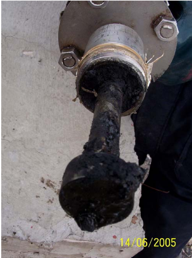
Estado de la probeta cuando se retira de la cañería
