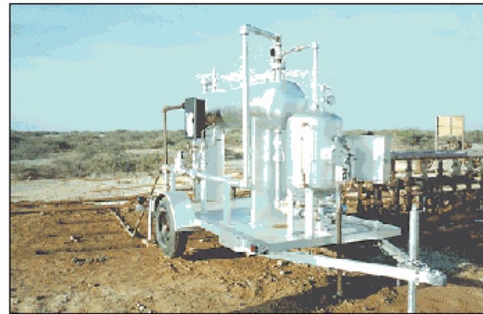
Figura 6. Medidor portátil de fluidos - instalado en un Manifold de Campo
