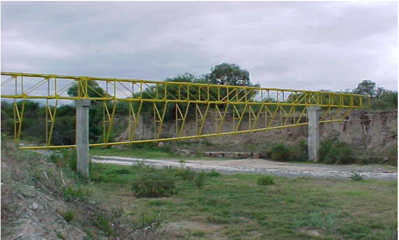
Instalación típica de un cruce de Gasoducto, con márgenes de ríos socavados
