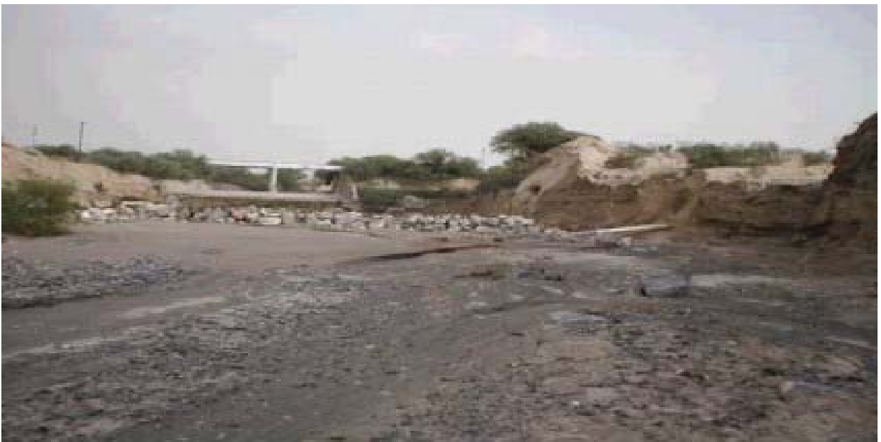
Márgenes descalzadas por erosión de suelo. Rotura de Zona de contención, del FFCC, por acción del agua.
