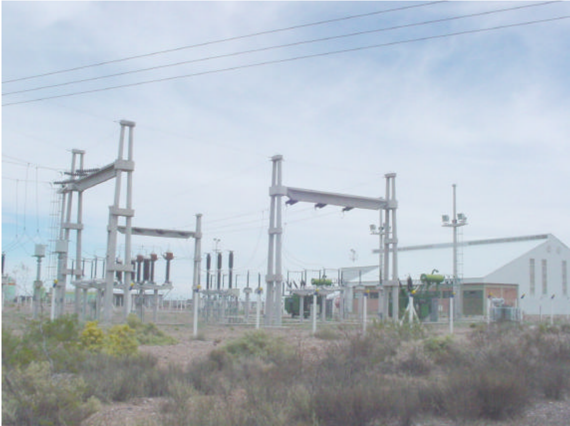
Figura 3: Fotografía panorámica de la Estación Transformadora.
