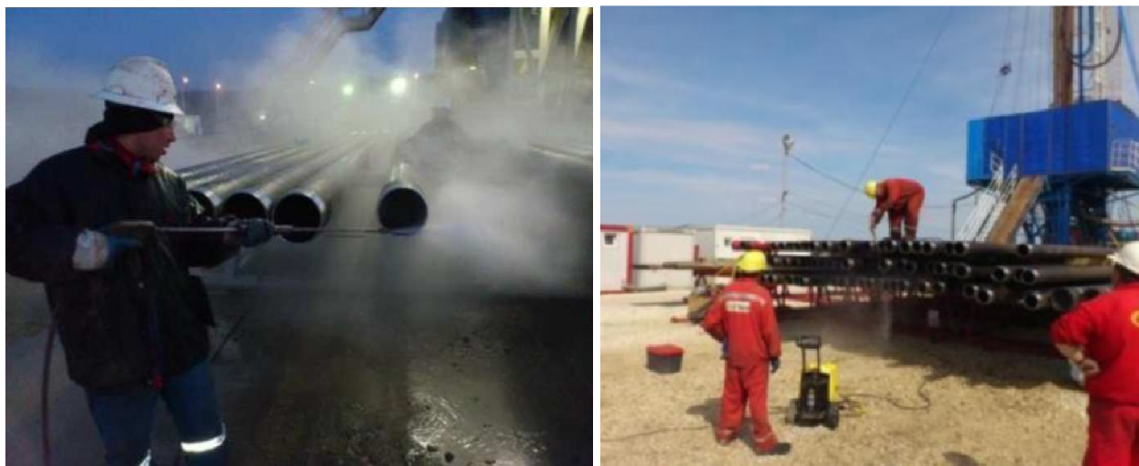
Fig 3: Personal expuesto a riesgos de alta presión de agua, caídas, esfuerzos físicos, atrapamiento de manos, etc , registrados durante la tarea de limpieza de conexiones en equipo de perforación.
