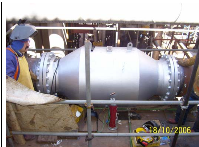
Silenciador en línea instalado en el mando del soplador
