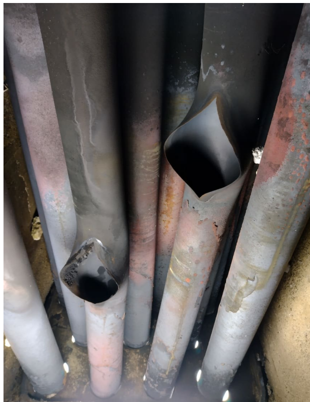
Figura 5. Fallas halladas en los tubos de la zona convectiva
