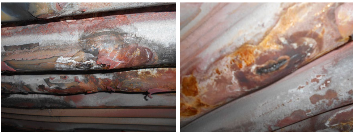
Figura 3: Fisuras en tubos de techo C-23 - 06/04/2021
