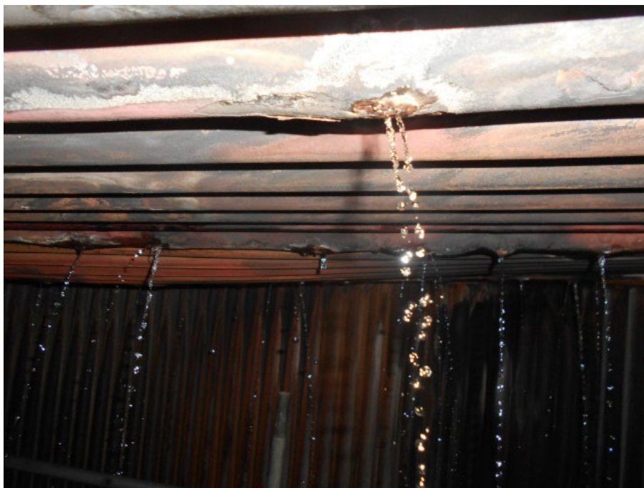
Figura 2: Fisura en tubos de techo C-25 - 24/02/2021
