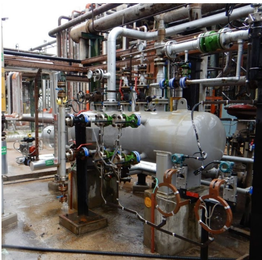
Ilustración 4 - Evaporador de propano E-2101.
