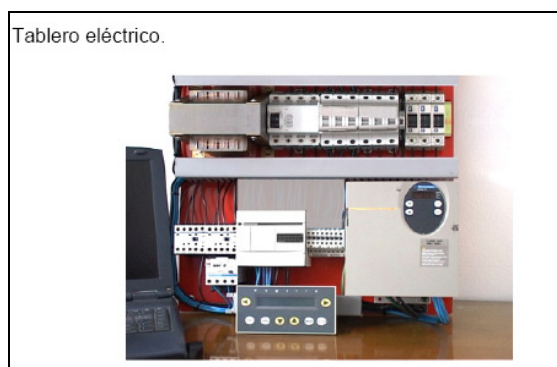
Figura 22. Tablero. Fuente: Manual de equipo. Evangelista S.A.
