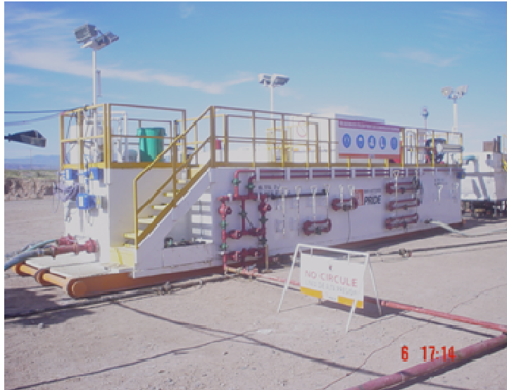
Figura 5. Pileta de ensayo del equipo ECFrac.
