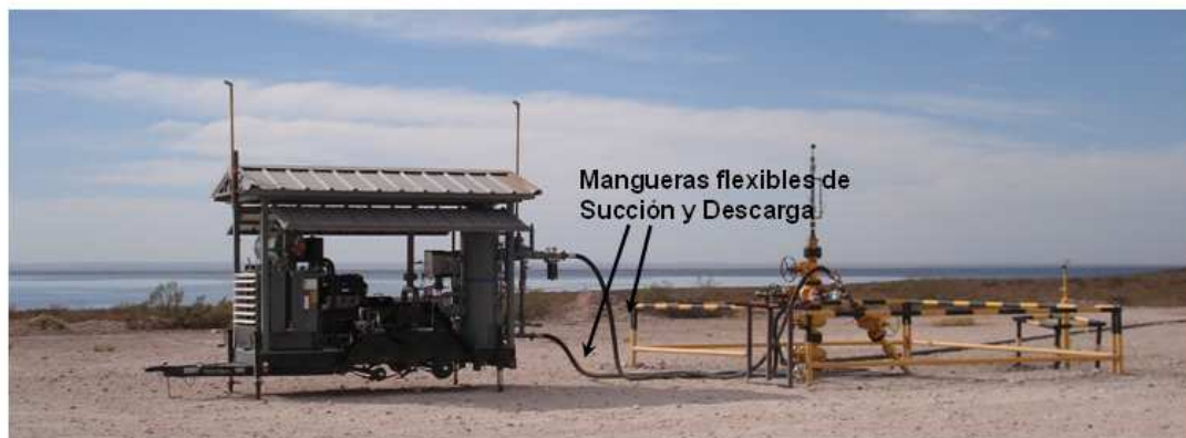
Fig. 8: Compresor instalado en boca de pozo
