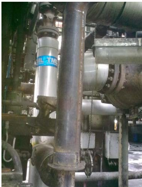
Figura 5. Circuito de recirculación de Gas Óil Pesado a Torre 201E.
