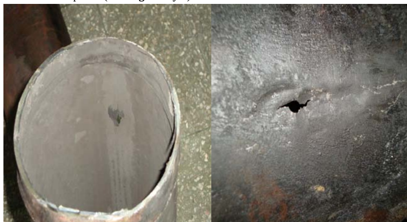
Figuras 3 y 4. Detalle de morfología de falla en línea de Carga.
