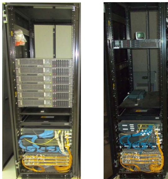
Figura 6. Equipos del sistema de control distribuido previo a la virtualización (izquierda) y luego de virtualizarlos y consolidarlos en un Host (derecha).
