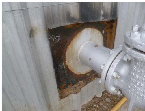
Figura 16. Evidencia de corrosión generalizada en boquillas.
