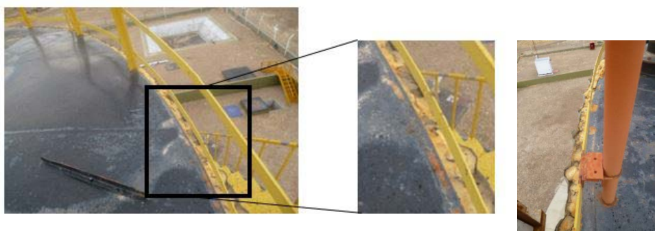
Figura 14. Falta de recubrimiento en unión techo-envolvente.
