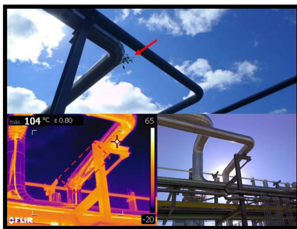
Figura 11 Detección de tubería área con indicios de humedad, inspección mediante cámara termográfica.
