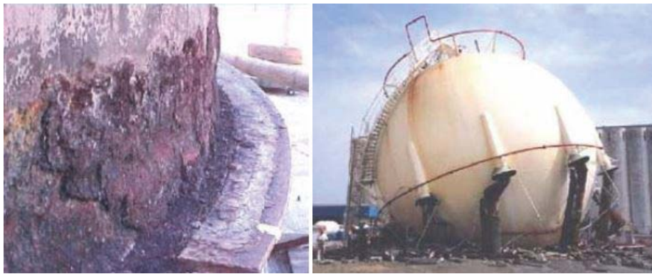
Figura 3. (A)CUI en anillo de soportación de tanque. (B) Corrosión bajo protección ignífuga en piernas de soportación de esfera. (Imagen extraída de API RP 583)
