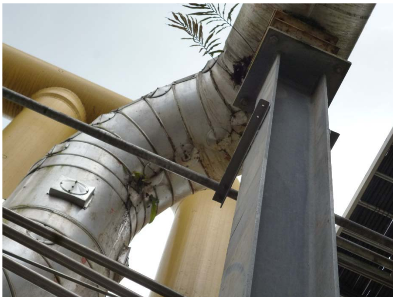
Figura 2. Presencia de humedad en soportes de tuberías.
